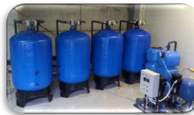
Буферная система отопления и ГВС. Система безопасности
